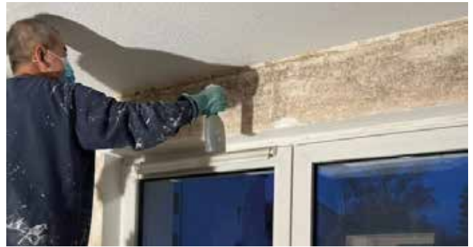
Folge durch Kipp-Lüftung: Schimmel im Innenraum
